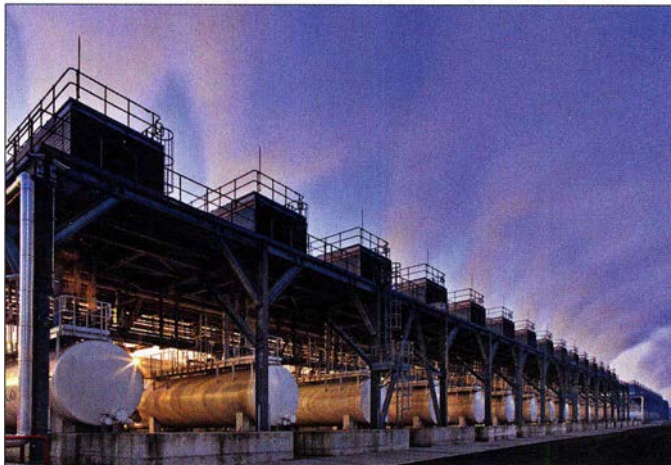
Wassertanks unter den Kühltürmen sorgen in St. Ghislain für ein sicheres Kühlssystem der Google-Server.
